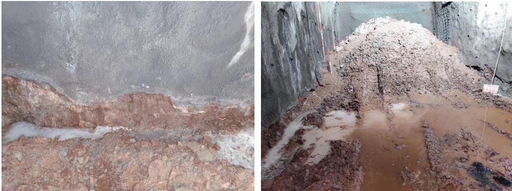
图 1 两帮底角渗水
